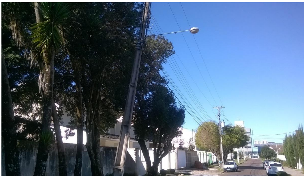
Figura 46: Problemas Encontrados – Rua Pedro Alberti
