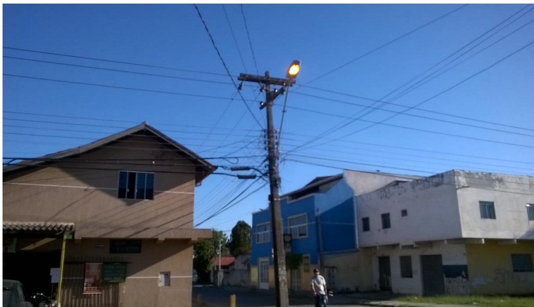
Figura 44: Problemas Encontrados – Rua Laerte Fenelon
