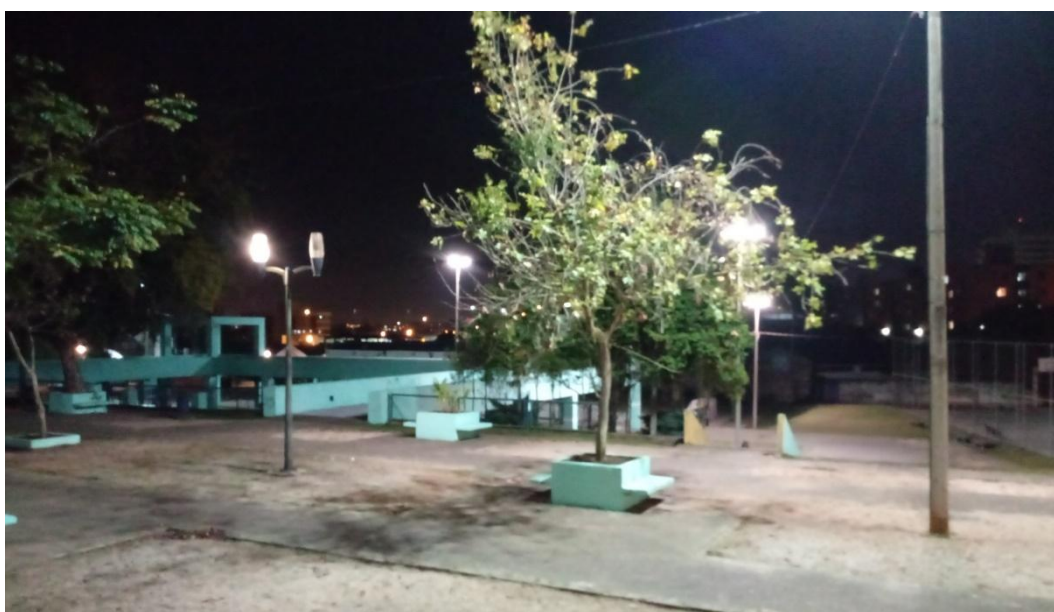
Figura 33: Instalações Luminotécnicas do Parque de Iluminação Pública Municipal – Praça do Verbo Divino
